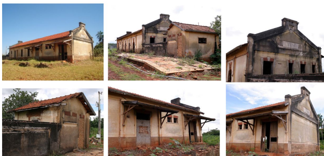
Figura 1. Conjunto da estação ferroviária após as intervenções descaracterizadoras.
