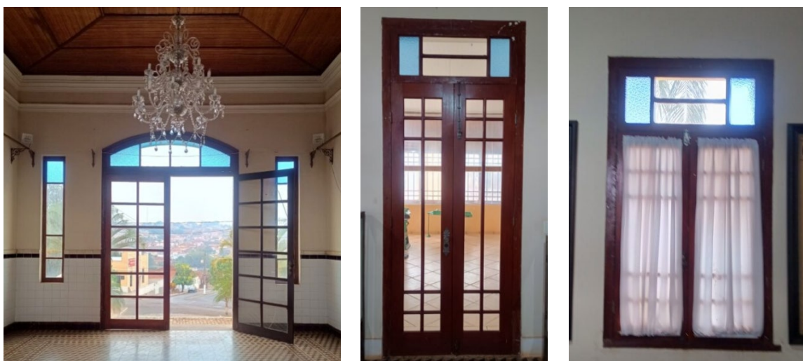
Figura 15. As esquadrias na atualidade.
