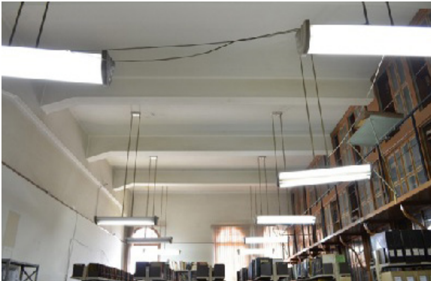
Figura 10. Luminárias na biblioteca do Museu Ferroviário de Jundiá
